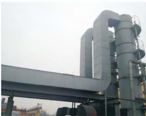
图 2 改造前现场 Fig. 2 The scene before modification
